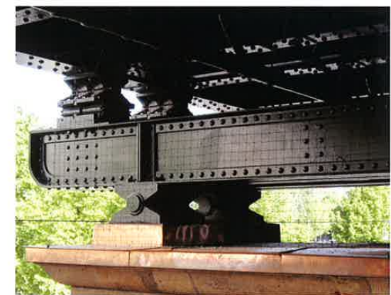
7. Sanierte Lagerkörper unterhalb des Bahnhofs Eberswalder Straße. Foto: Lorenz & Co. Bauingenieure.
